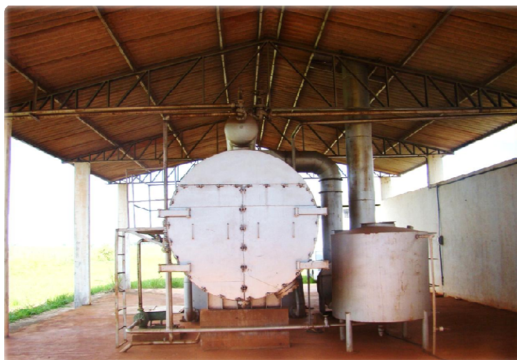
Barracão da Caldeira Interno
