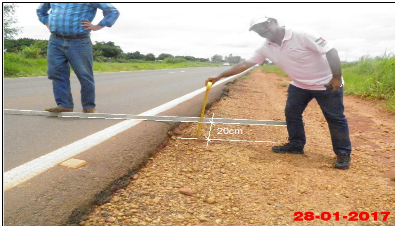
Foto 14 – Vista geral do desnível da Rodovia Arlindo Bértio (SP-613) com o seu acostamento do lado direito no sentido à Rosana.
