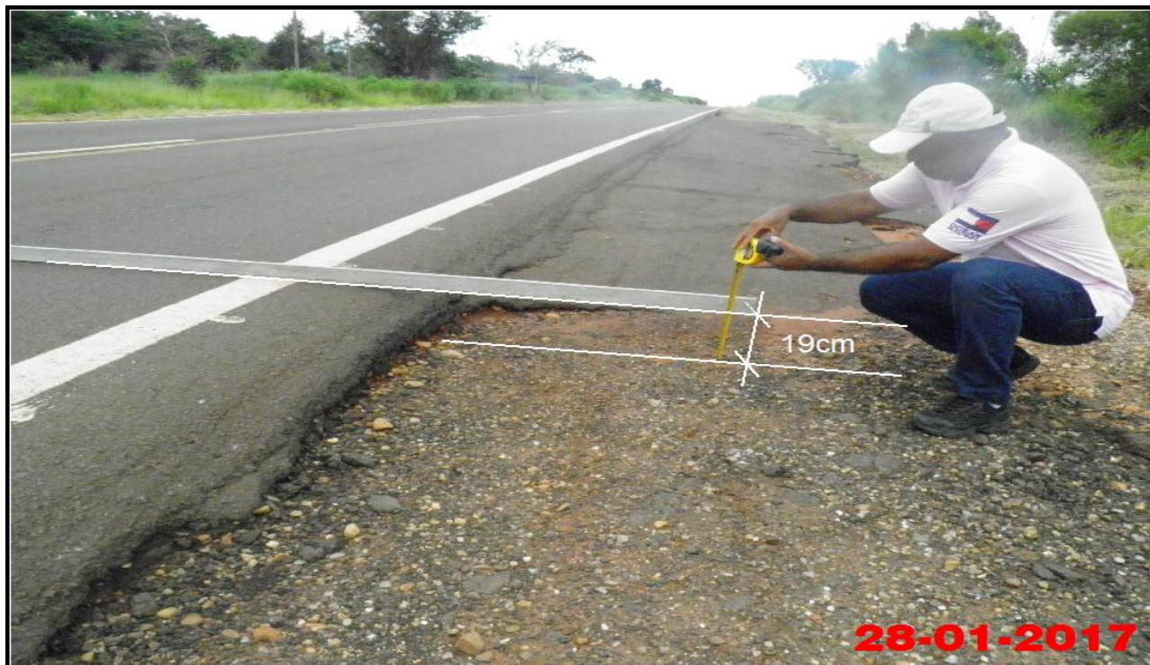
Foto 04 – Vista geral do desnível da Rodovia Arlindo Bétio (SP-613) com o seu acostamento do lado direito no sentido à Rosana.
