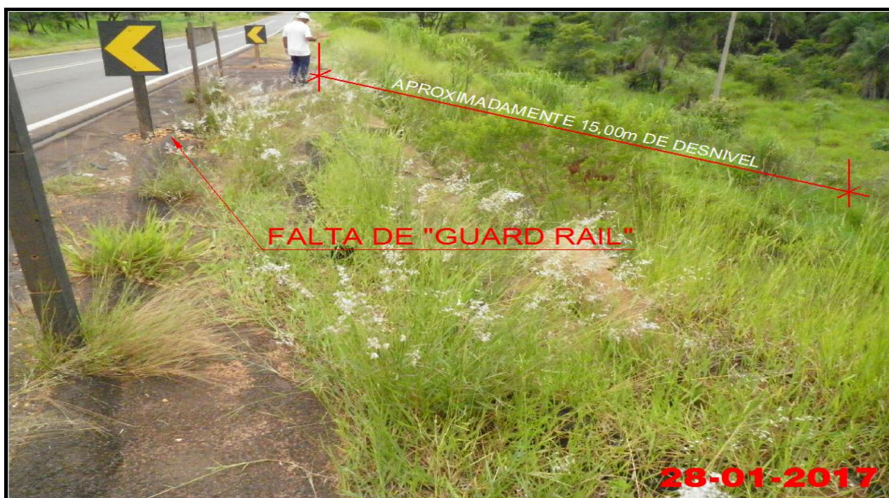
Foto G – Vista geral da Erosão e falta de proteção tipo “Guard Rail” na lateral deste trecho devido a um desnível de aproximadamente 15,00 metros.
