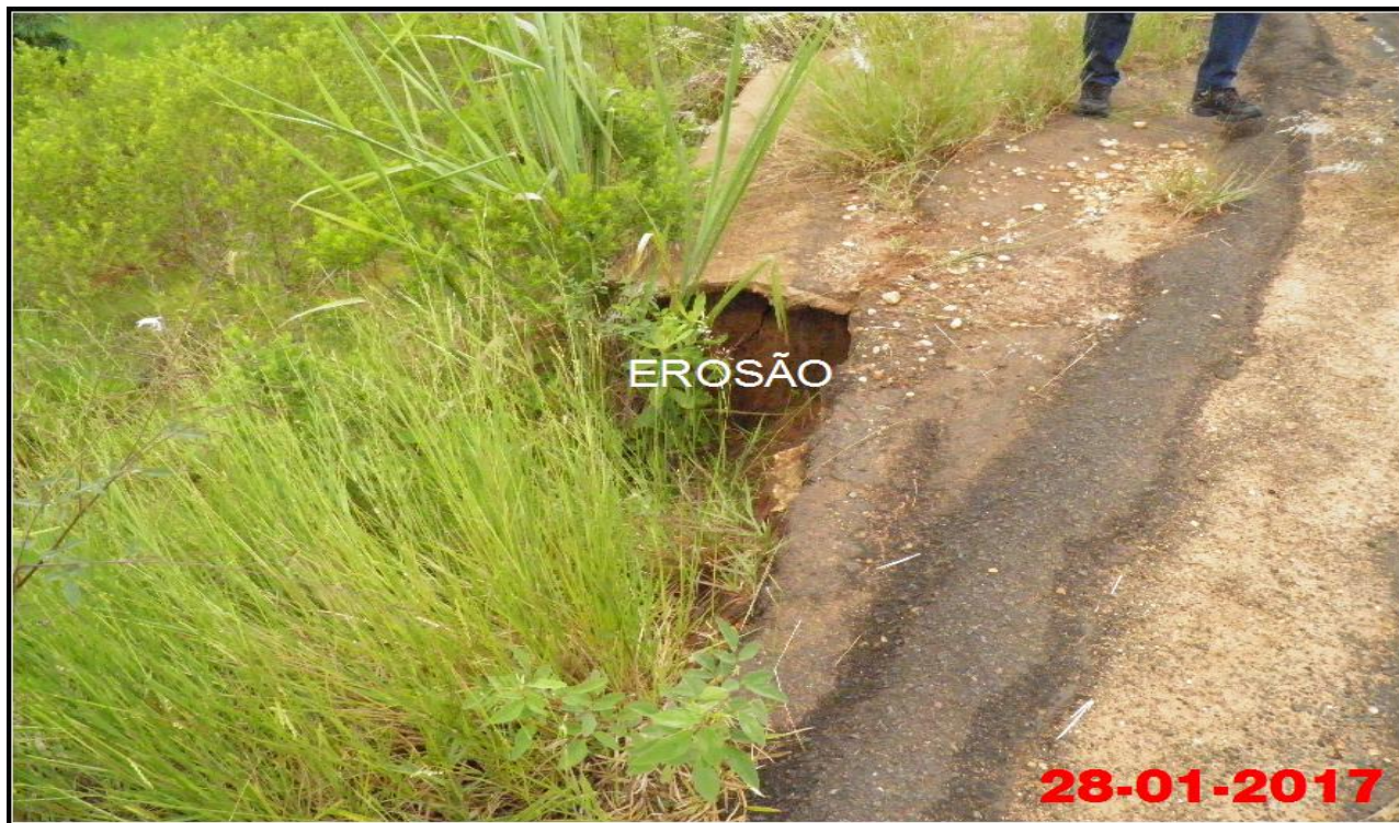
Foto D – Vista geral da Erosão que vem provocando o estreitamento da pista (perda de acostamento).
