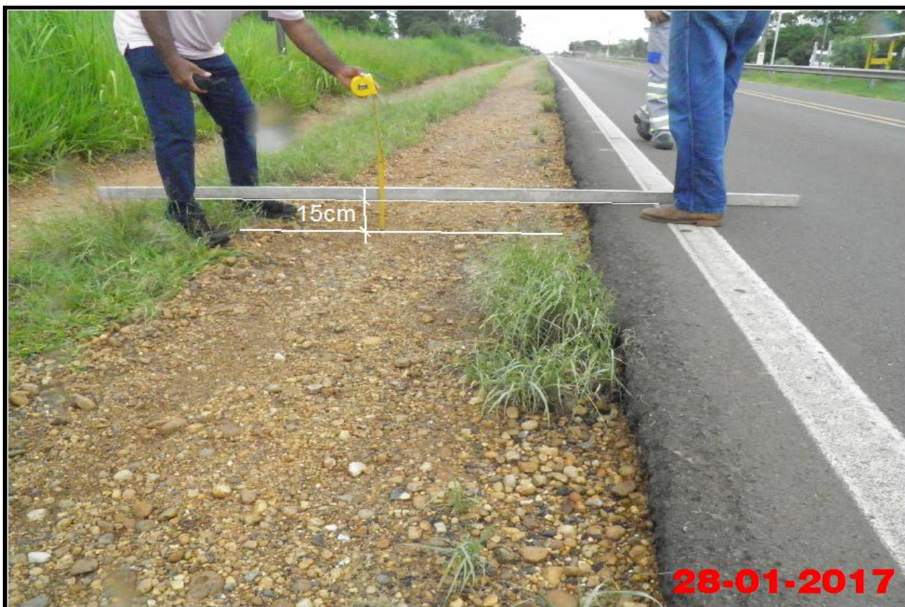
Foto 29 – Vista geral do desnível da Rodovia Arlindo Bétio (SP-613) com o seu acostamento do lado direito no sentido à Rosana.
