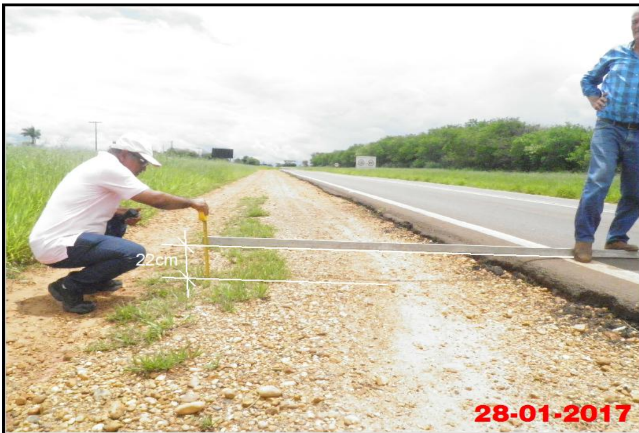
Foto 35 – Vista geral do desnível da Rodovia Arlindo Bértio (SP-613) com o seu acostamento do lado esquerdo no perímetro urbano de Primavera sentido à Rosana.
