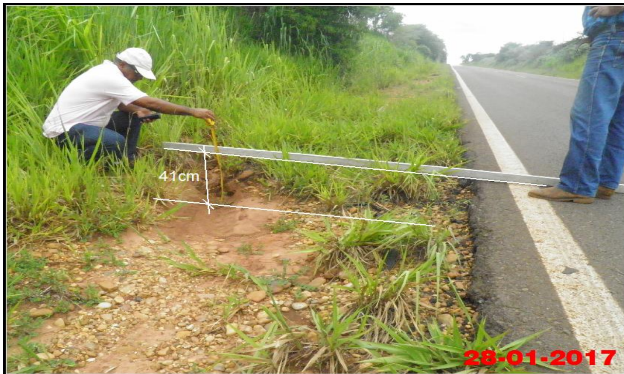
Foto 26 – Vista geral do desnível da Rodovia Arlindo Bértio (SP-613) com o seu acostamento do lado direito no sentido à Rosana.
