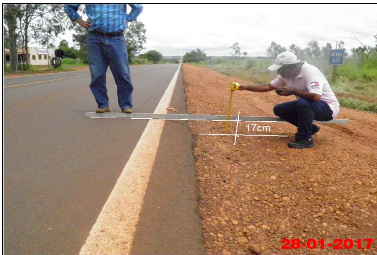
Foto 11 – Vista geral do desnível da Rodovia Arlindo Bértio (SP-613) com o seu acostamento do lado direito no sentido à Rosana.
