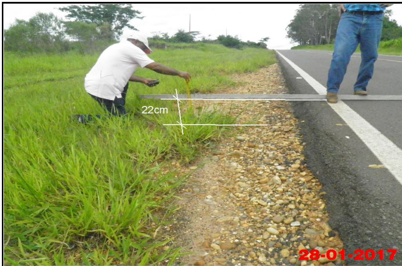
Foto 36 – Vista geral do desnível da Rodovia Arlindo Bértio (SP-613) com o seu acostamento do lado direito no sentido à Rosana.
