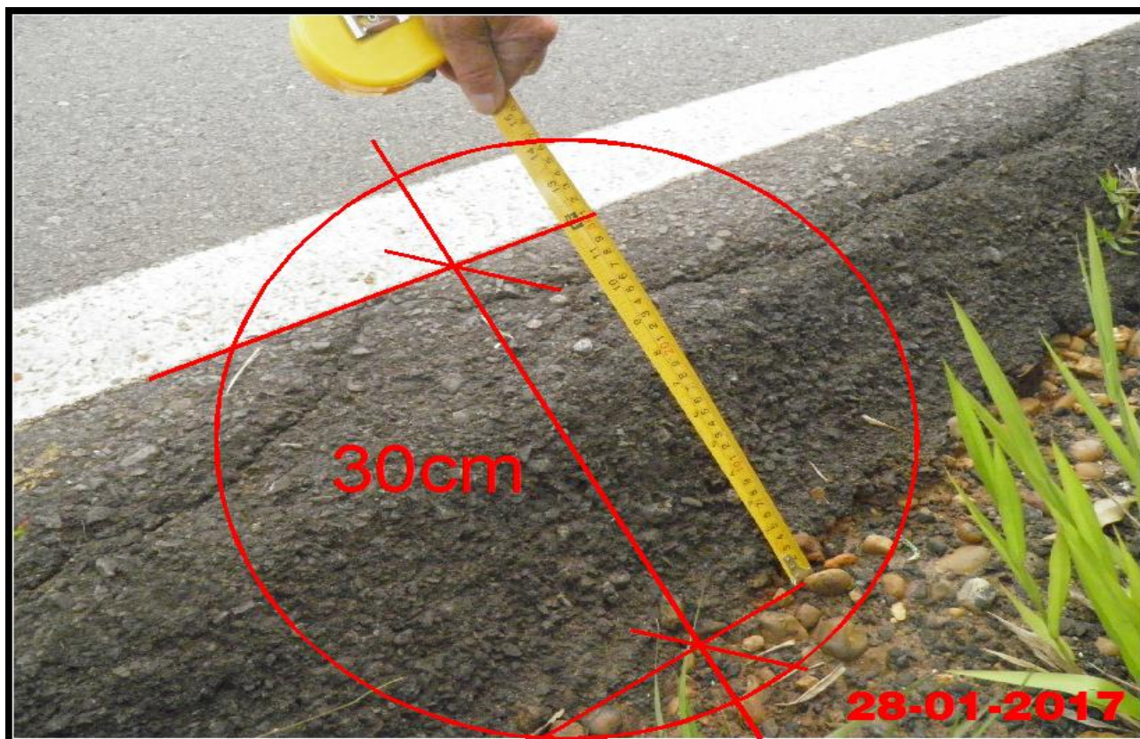
Foto 40 – Vista do Detalhe mostrando o desnível da Rodovia Arlindo Bétio (SP-613) com o seu acostamento do lado direito próximo a entrada do Bairro Saúva no sentido à Rosana.
