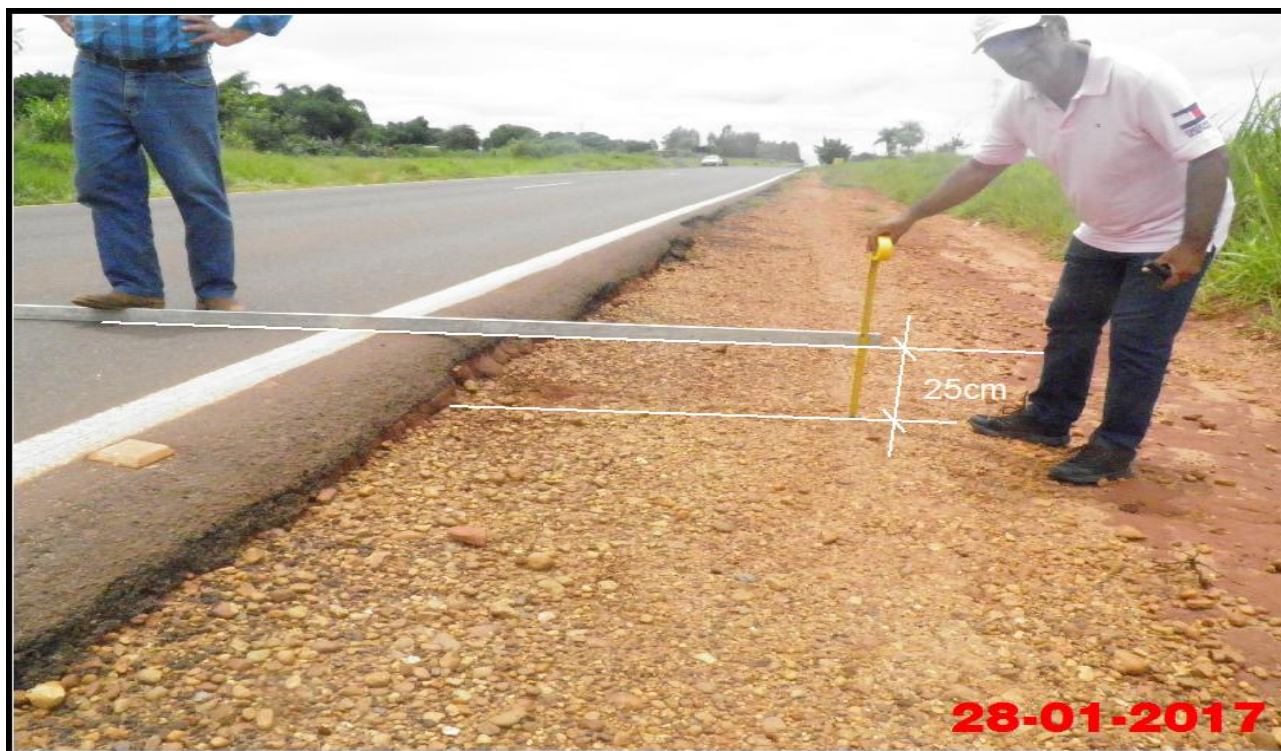
Foto 15 – Vista geral do desnível da Rodovia Arlindo Bértio (SP-613) com o seu acostamento do lado direito no sentido à Rosana.
