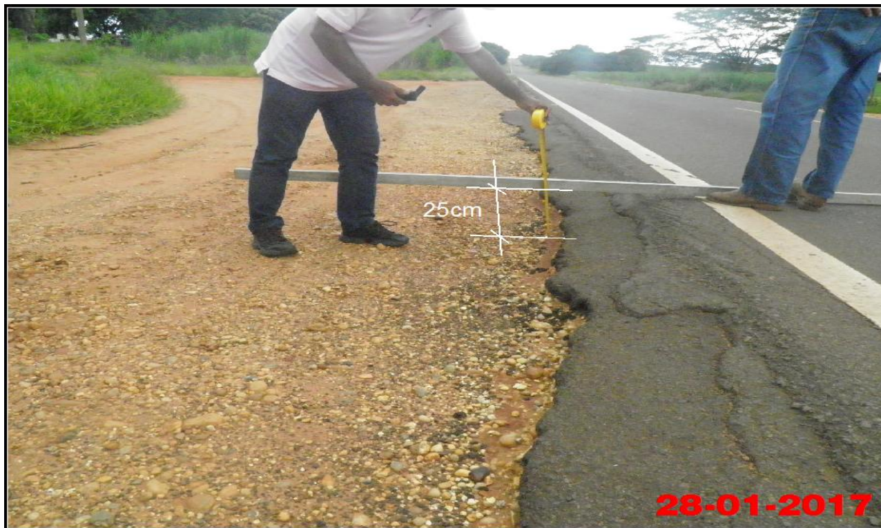
Foto 41 – Vista geral do desnível da Rodovia Arlindo Bértio (SP-613) com o seu acostamento do lado direito no sentido à Rosana.
