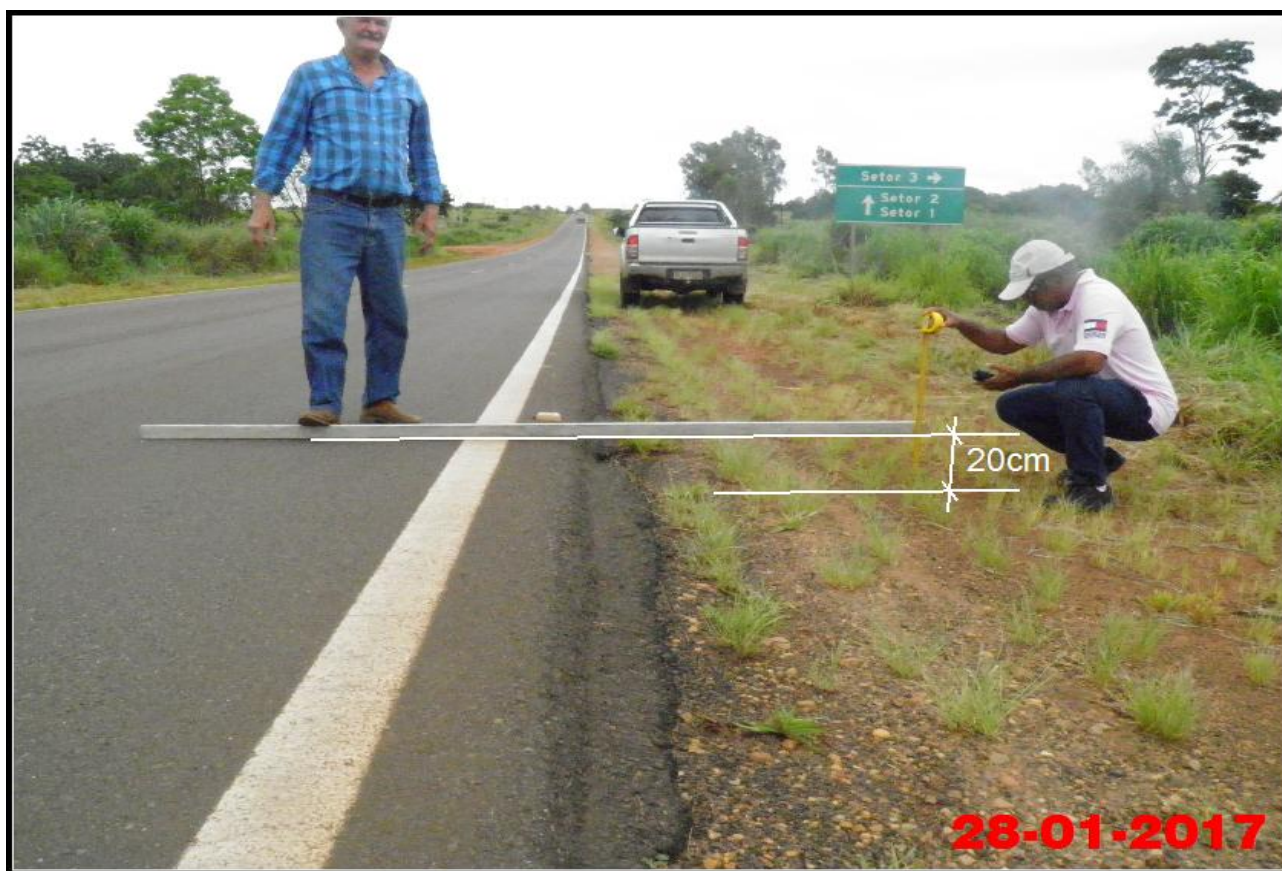
Foto 07 – Vista geral do desnível da Rodovia Arlindo Bértio (SP-613) com o seu acostamento do lado direito no sentido à Rosana.
