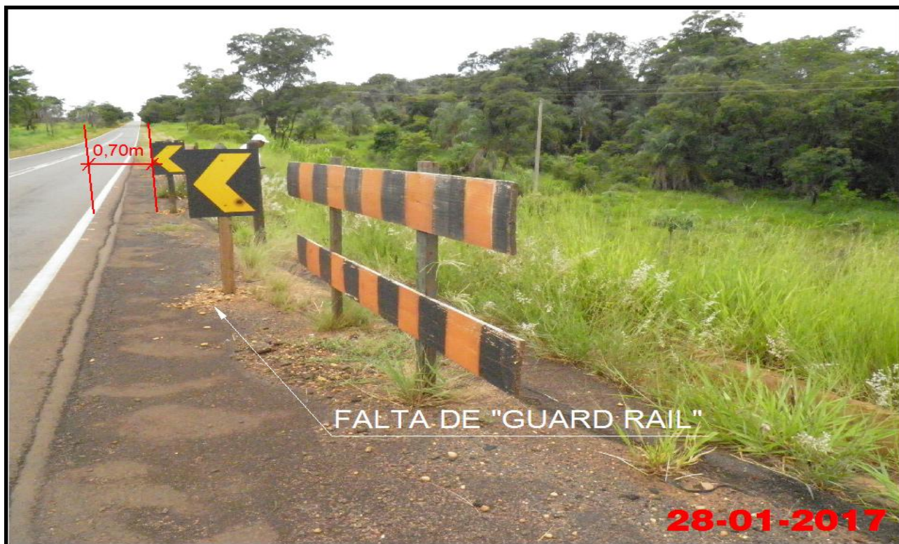
Foto F – Vista geral da falta de proteção tipo “Guard Rail” em função do estreitamento da pista e da distância da sinalização em relação à Rodovia.
