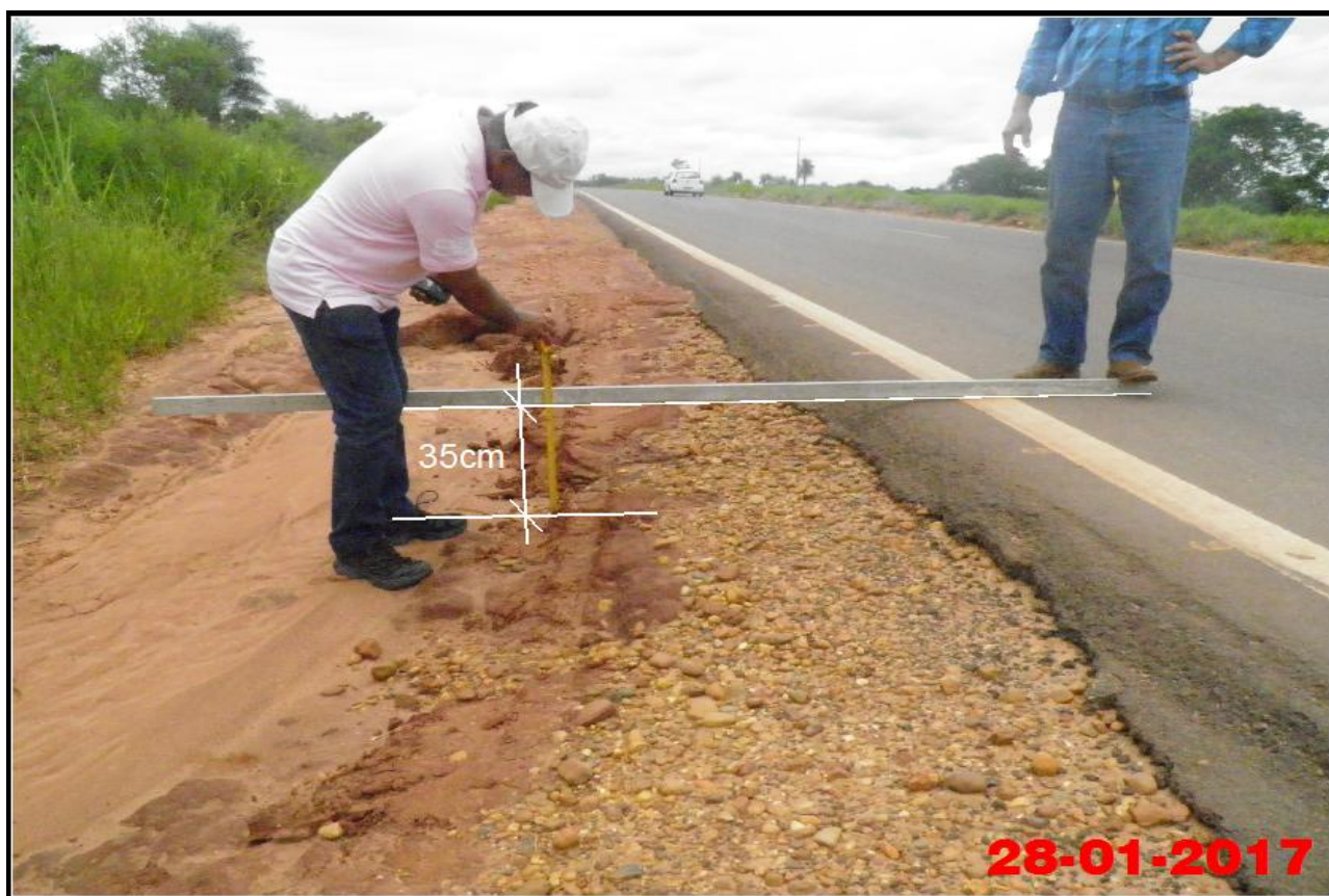
Foto 18 – Vista geral do desnível da Rodovia Arlindo Bértio (SP-613) com o seu acostamento do lado direito no sentido à Rosana.
