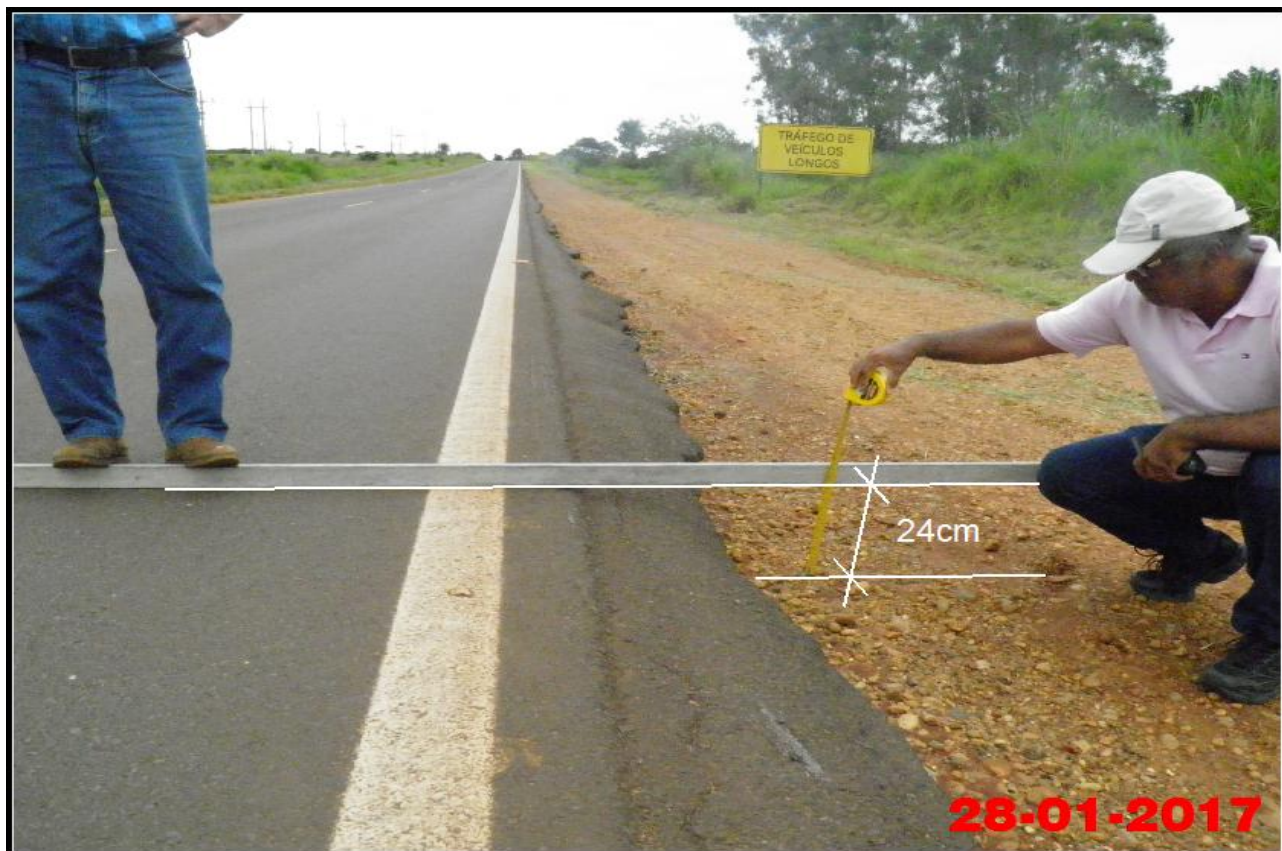
Foto 08 – Vista geral do desnível da Rodovia Arlindo Bértio (SP-613) com o seu acostamento do lado direito no sentido à Rosana.
