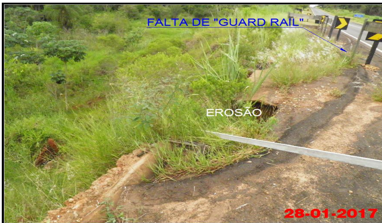
Foto C – Vista geral da Erosão e falta de proteção tipo “Guard Rail” na lateral deste trecho em função do estreitamento da pista (perda de acostamento).
