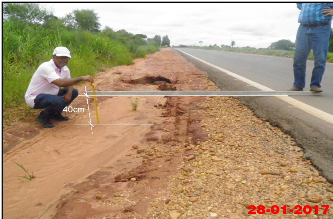
Foto 19 – Vista geral do desnível da Rodovia Arlindo Bétio (SP-613) com o seu acostamento do lado direito no sentido à Rosana.
