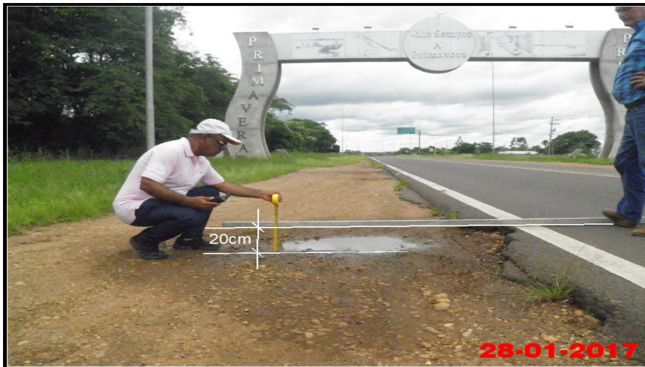
Foto 32 – Vista geral do desnível da Rodovia Arlindo Bétio (SP-613) com o seu acostamento do lado direito no perímetro urbano de Primavera sentido à Rosana.
