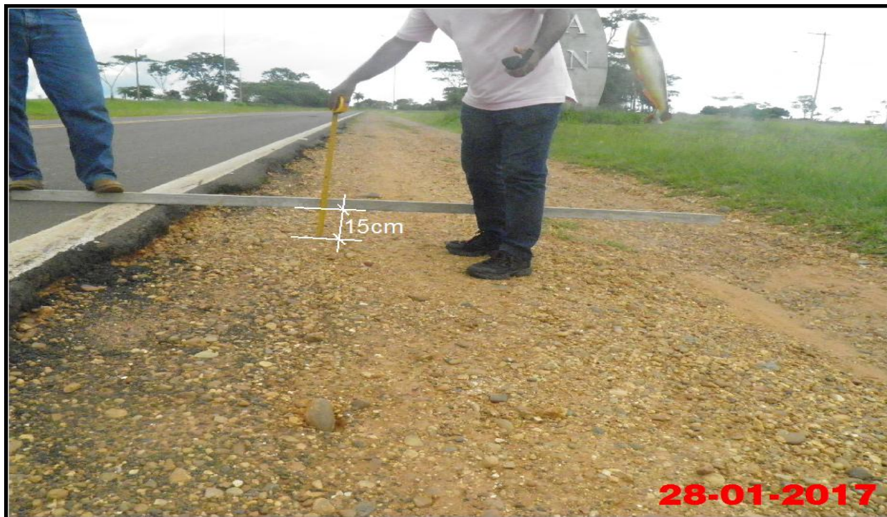
Foto 44 – Vista geral do desnível da Rodovia Arlindo Bétio (SP-613) com o seu acostamento do lado direito no perímetro urbano no sentido à Rosana.
