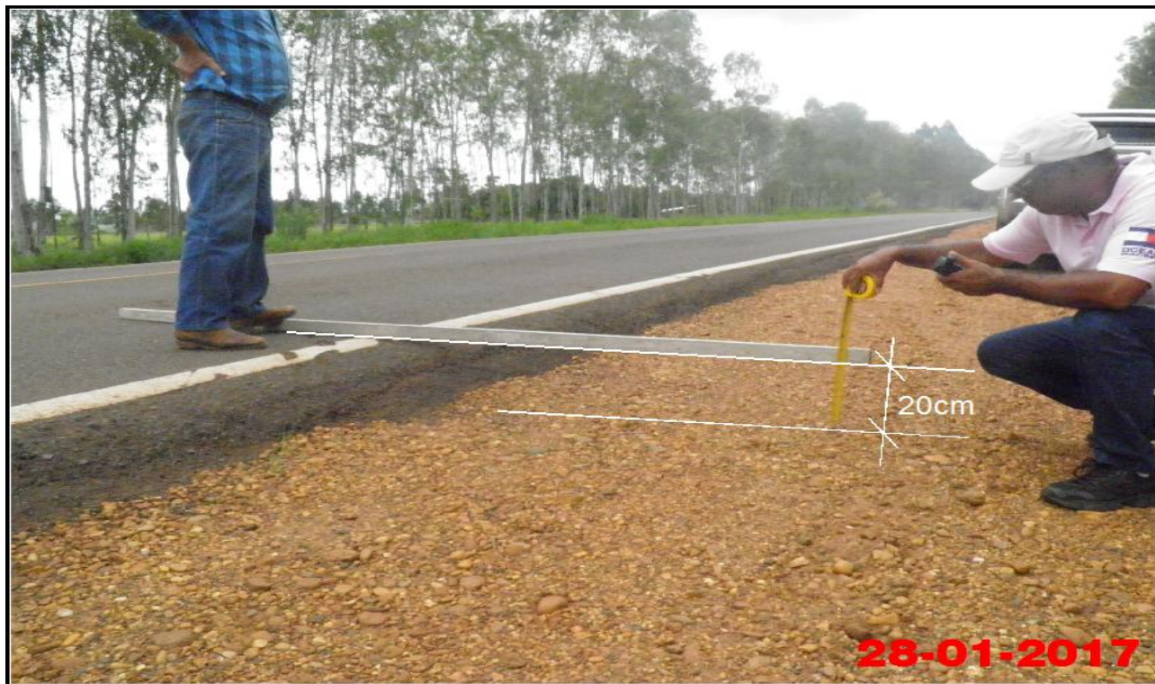
Foto 21 – Vista geral do desnível da Rodovia Arlindo Bértio (SP-613) com o seu acostamento do lado direito no sentido à Rosana.
