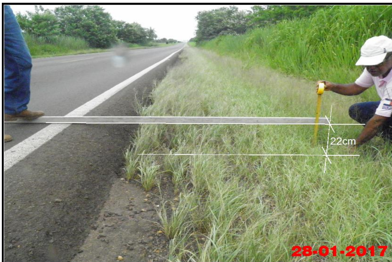
Foto 30 – Vista geral do desnível da Rodovia Arlindo Bértio (SP-613) com o seu acostamento do lado direito no sentido à Rosana.
