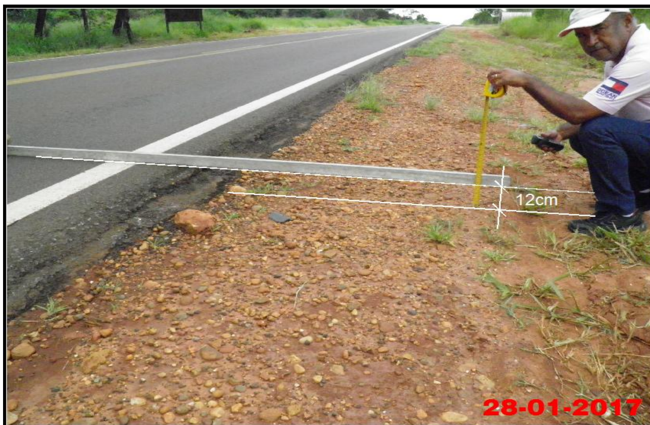
Foto 01 – Vista geral do desnível da Rodovia Arlindo Bétio (SP-613) com o seu acostamento do lado direito no sentido à Rosana.
