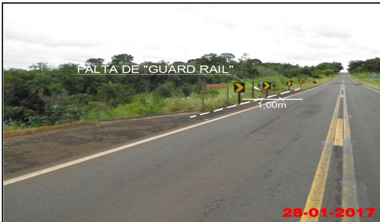
Foto B – Vista geral da falta de proteção tipo “Guard Rail” na lateral deste trecho em função do estreitamento da pista (perda de acostamento).
