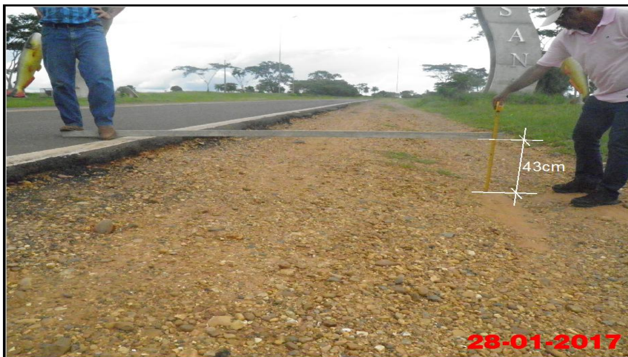
Foto 45 – Vista geral do desnível da Rodovia Arlindo Bétio (SP-613) com o seu acostamento do lado direito no perímetro urbano no sentido à Rosana.
