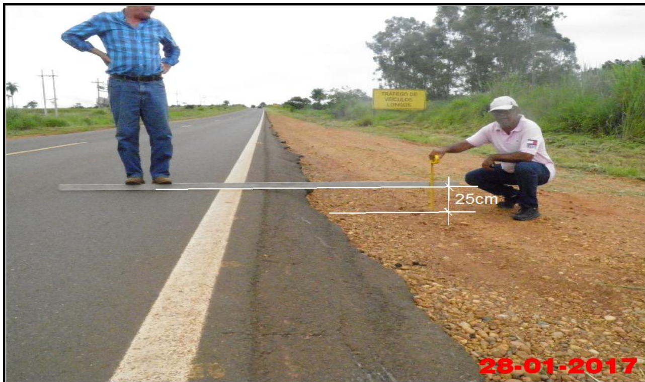
Foto 09 – Vista geral do desnível da Rodovia Arlindo Bértio (SP-613) com o seu acostamento do lado direito no sentido à Rosana.
