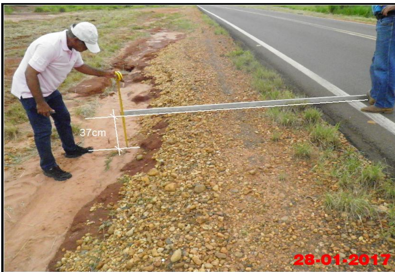
Foto 06 – Vista geral do desnível da Rodovia Arlindo Bétio (SP-613) com o seu acostamento do lado direito no sentido à Rosana.
