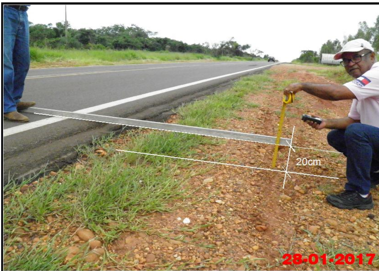
Foto 02 – Vista geral do desnível da Rodovia Arlindo Bértio (SP-613) com o seu acostamento do lado direito no sentido à Rosana.
