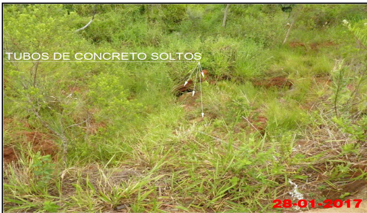
Foto E – Vista geral da erosão que é bastante significativa, comprometendo o acostamento, onde houve a perda do aterro e das tubulações.
