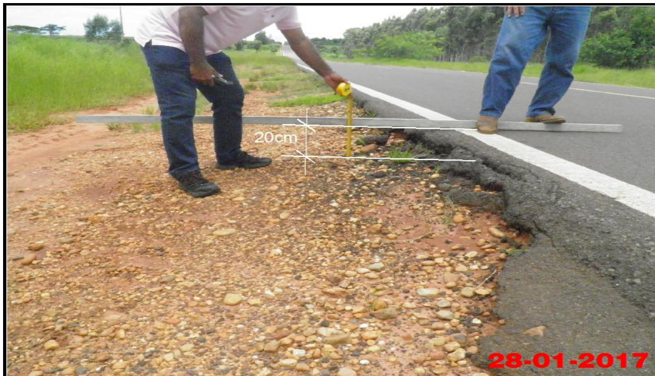
Foto 38 – Vista geral do desnível da Rodovia Arlindo Bértio (SP-613) com o seu acostamento do lado direito no sentido à Rosana.
