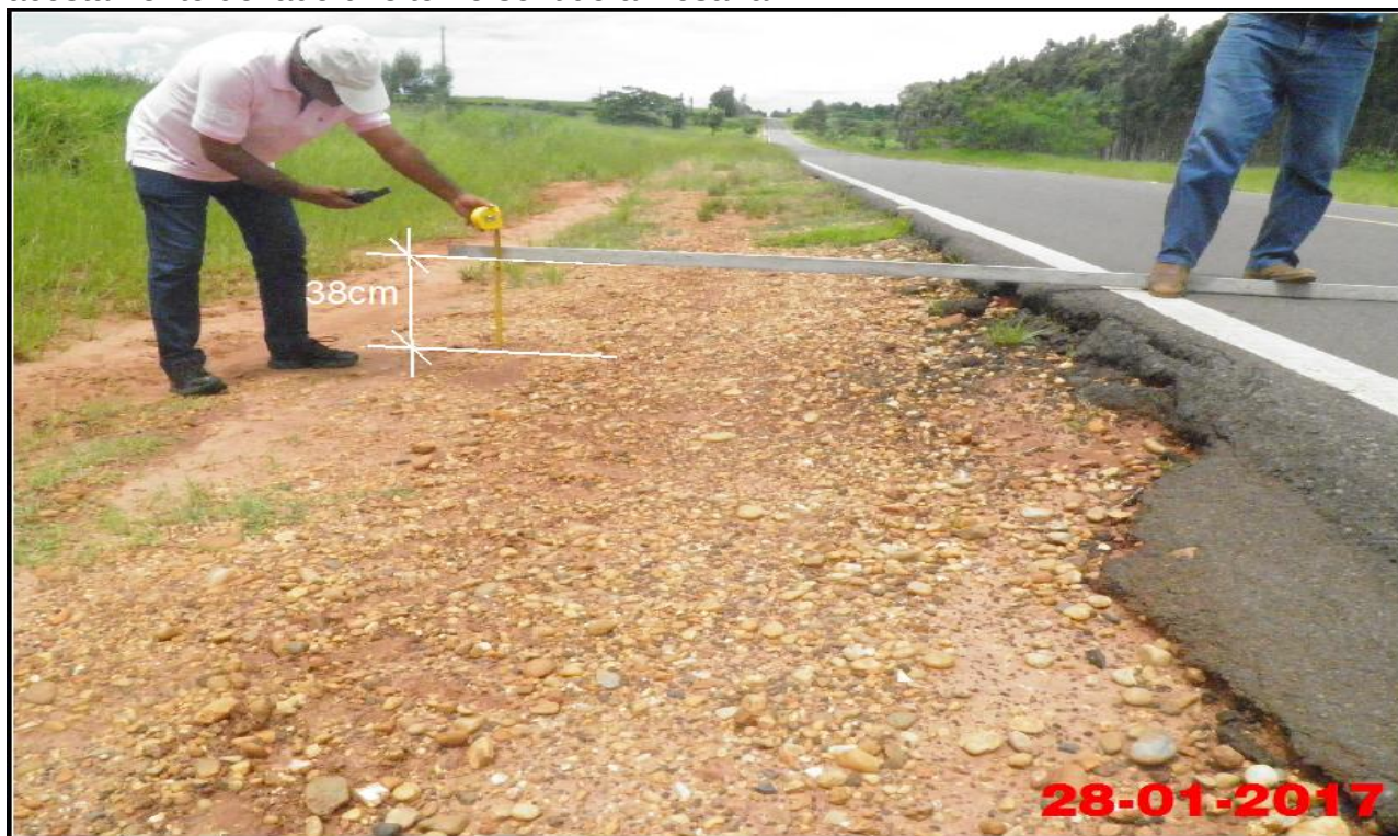
Foto 39 – Vista geral do desnível da Rodovia Arlindo Bértio (SP-613) com o seu acostamento do lado direito no sentido à Rosana.
